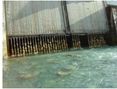
Une grille endommagée n'a plus la même capacité de protection (Aquarius)
