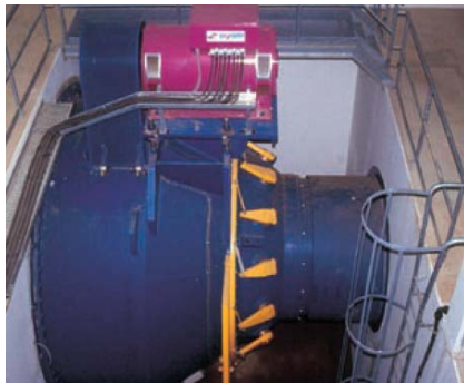
Turbine Kaplan type bulbe avec générateur.
