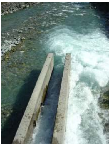
Zones de fortes turbulences dans la passe dues à un débit trop important
