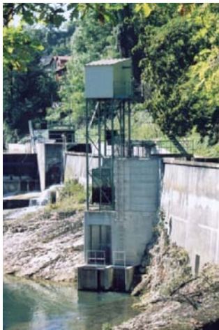
Ascenseur à poissons, Birse (Hydrosolar)
