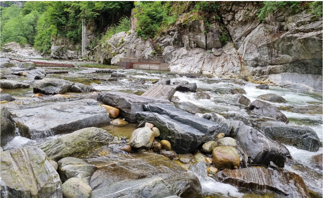
Figura 5-6: maggio 2022 – tratto subito a valle della soglia di monte (tratto non interessato dal cedimento)
