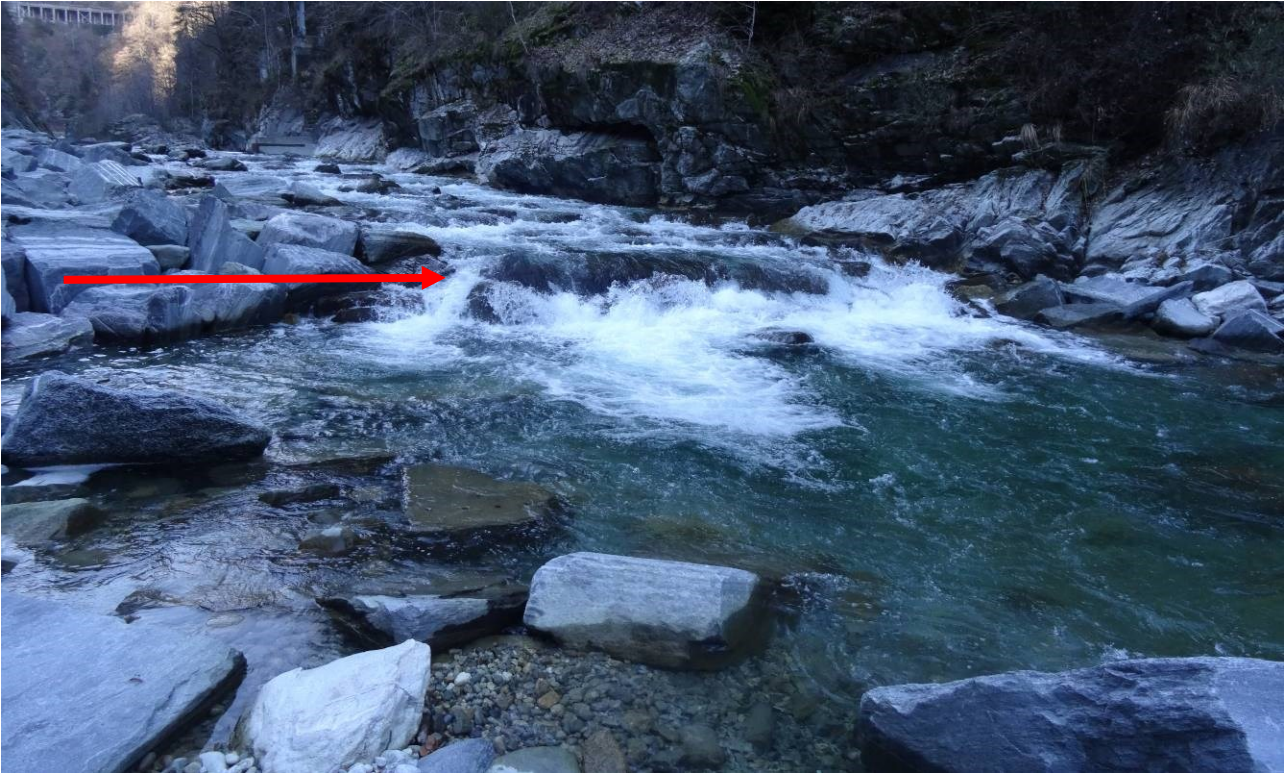
Figura 4-3: la rampa dopo il cedimento (freccia rossa indica il punto di cedimento)
