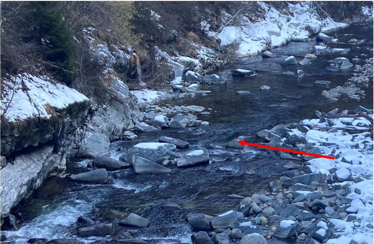
Figura 4-7: la rampa dopo il ripristino; si può notare come il dislivello sia scomparso (freccia rossa indica il punto di cedimento ripristinato)
