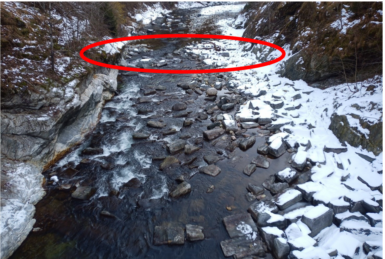
Figura 4-2: la rampa dopo il ripristino; si può notare come il dislivello sia scomparso
