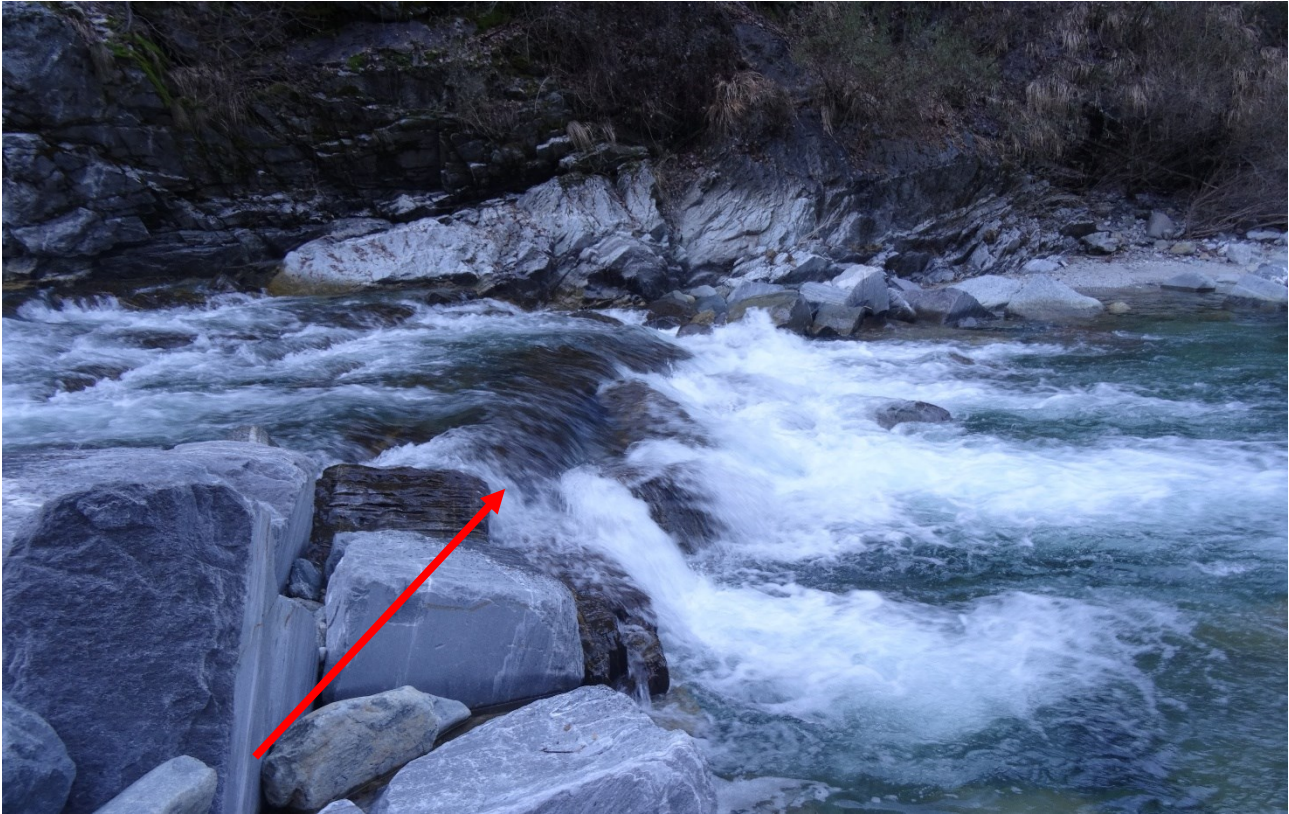
Figura 4-5: la rampa dopo il cedimento (freccia rossa indica il punto di cedimento)
