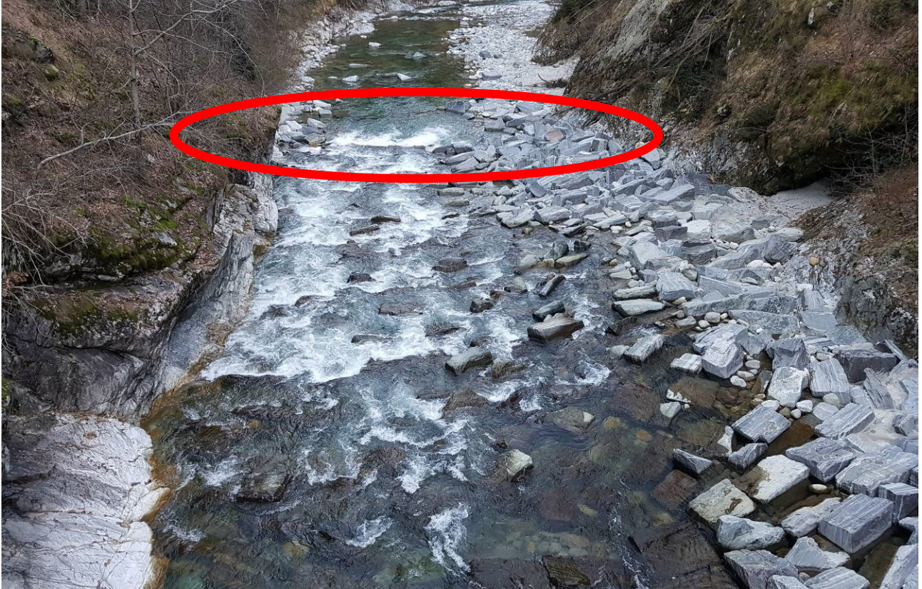
Figura 4-1: la rampa dopo il cedimento
