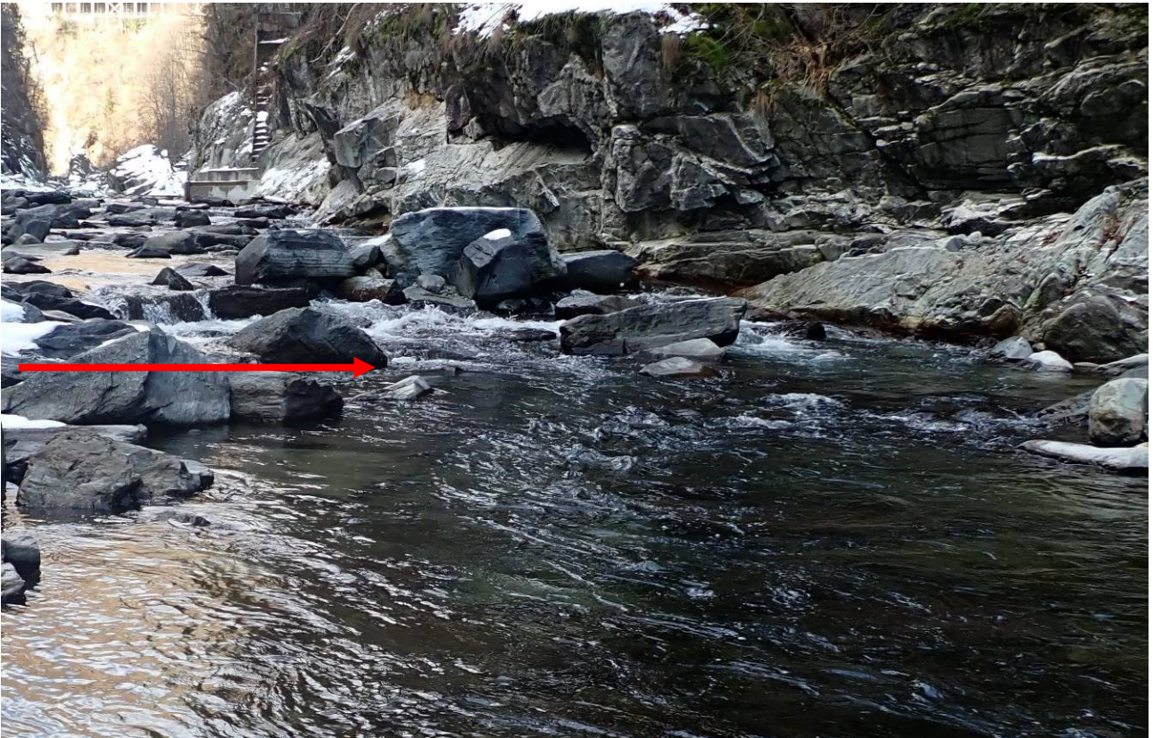
Figura 4-9: la rampa dopo il ripristino; si può notare come il dislivello sia scomparso (freccia rossa indica il punto di cedimento ripristinato)
