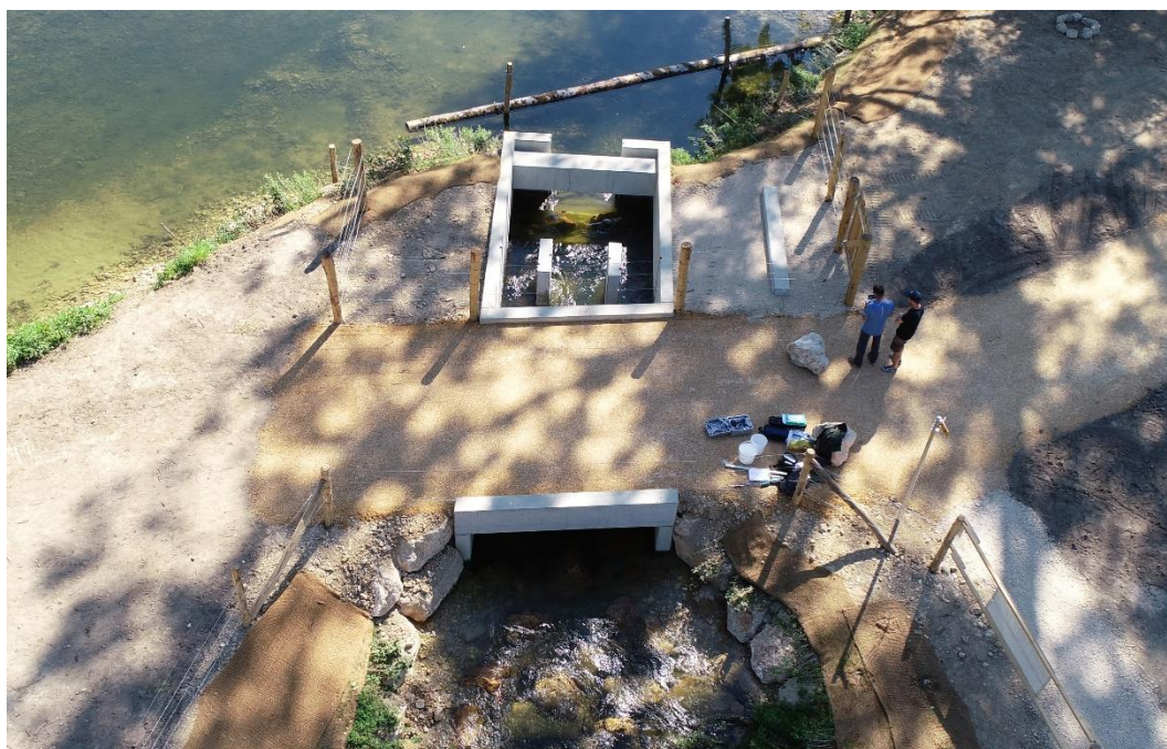
Figure 7 Secteur de prise d'eau du dispositif de montaison. Source : Aquarius, 2019.
