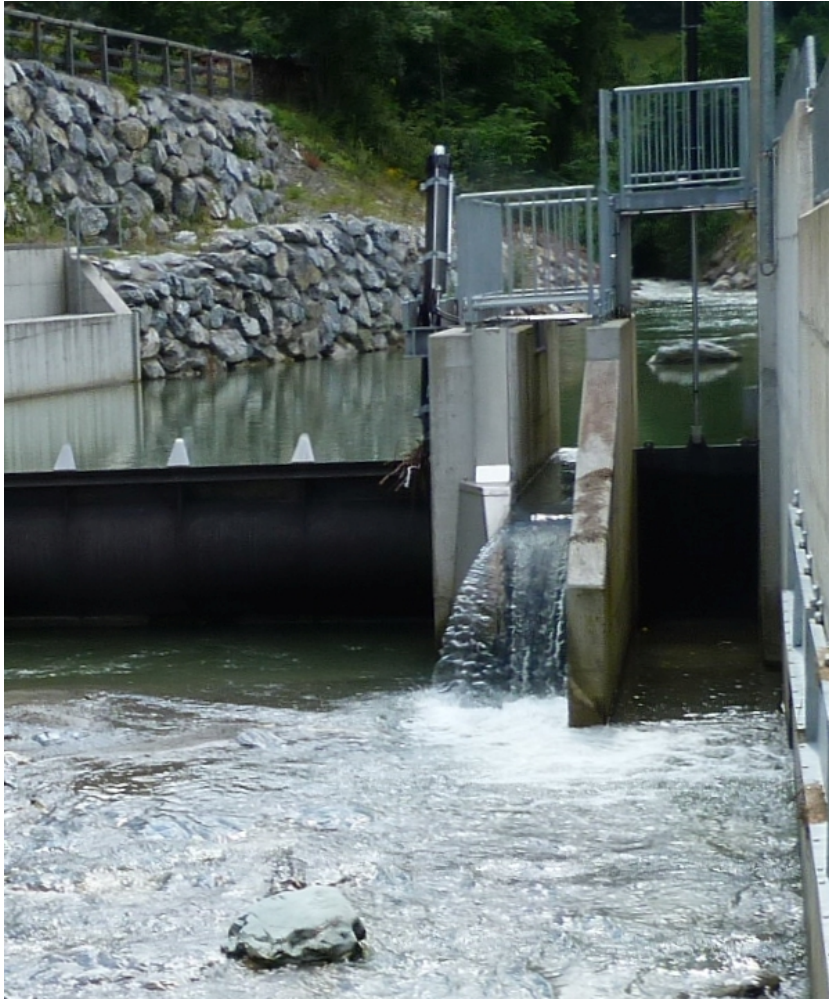
Abbildung 2: Abstiegsklappe/Restwasserklappe an der Wasserfassung des KW Fritzbach.
