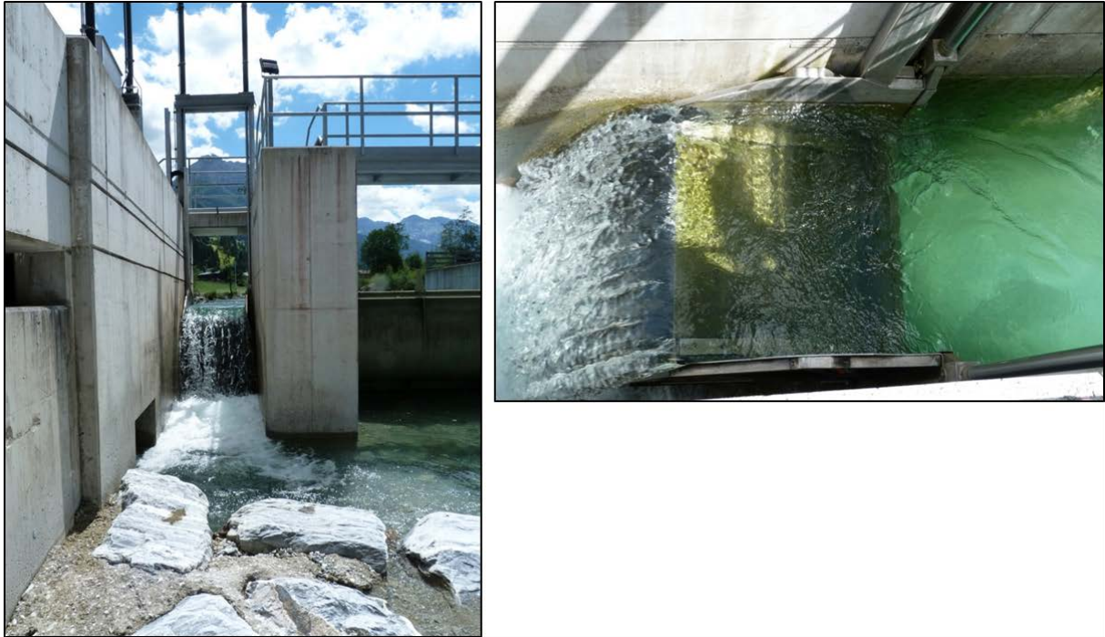
Abbildung 8: Abstieg-/Restwasserklappe an der Wasserfassung des KW Kleinarl.
