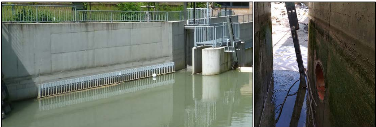
Abbildung 5: (links) Wasserfassung Hütttau mit Louver. Am unteren Ende des Louvers folgt ein Spülschütz sowie (versetzt) der Zulauf zur Abstiegsklappe, (rechts) Rohrdurchlass auf der dem Ufer zugewandten Seite des Zulaufkanals zur Abstiegsklappe.
