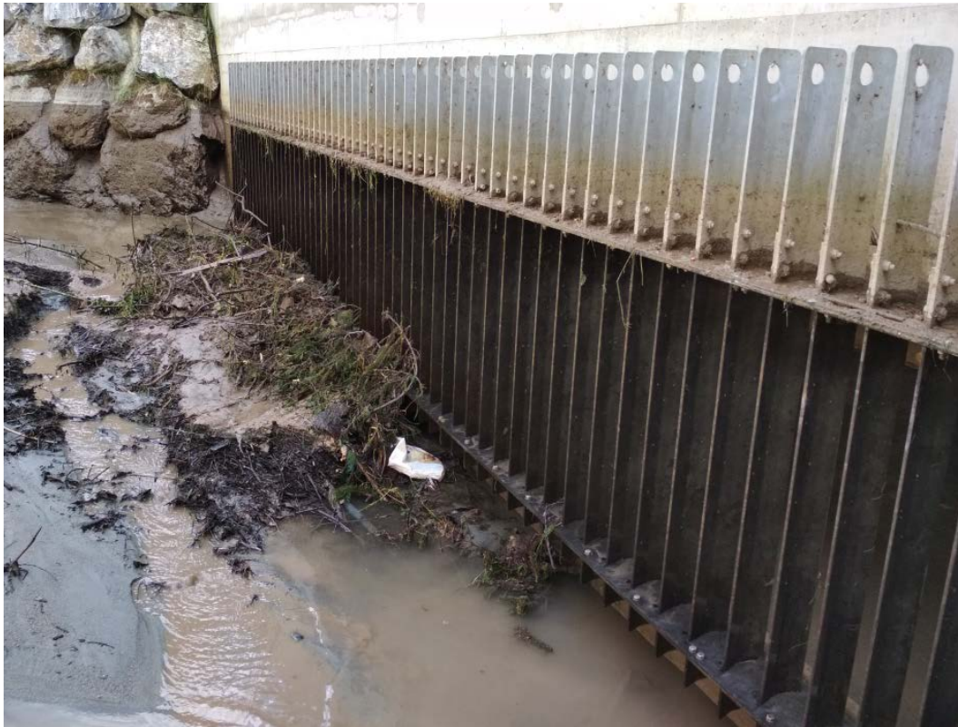
Abbildung 3: Ansicht des (nicht eingestauten) Louvers an der Wasserfassung Hütttau in Richtung stromauf.
