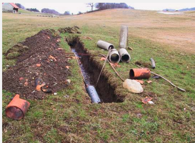
Fig. 3 ... und die damit verbundene gezielte Behebung von lokalen Schäden wie der punktuelle Ersatz einer defekten Sammelleitung ... et la suppression des dommages locaux tel que le remplacement ponctuel d'une conduite défectueuse
