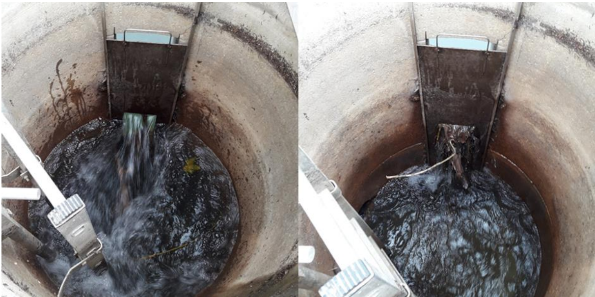
Abbildung 16: Sicht in die Vorkammer des Bypasses am KW Schiffmühle. Links: Grosser Durchfluss und kaum Verstopfung nach der Reinigung. Rechts: Mit Treibgut verlegte Öffnungen in der Lochblende und in Folge nur noch geringer Durchfluss.
