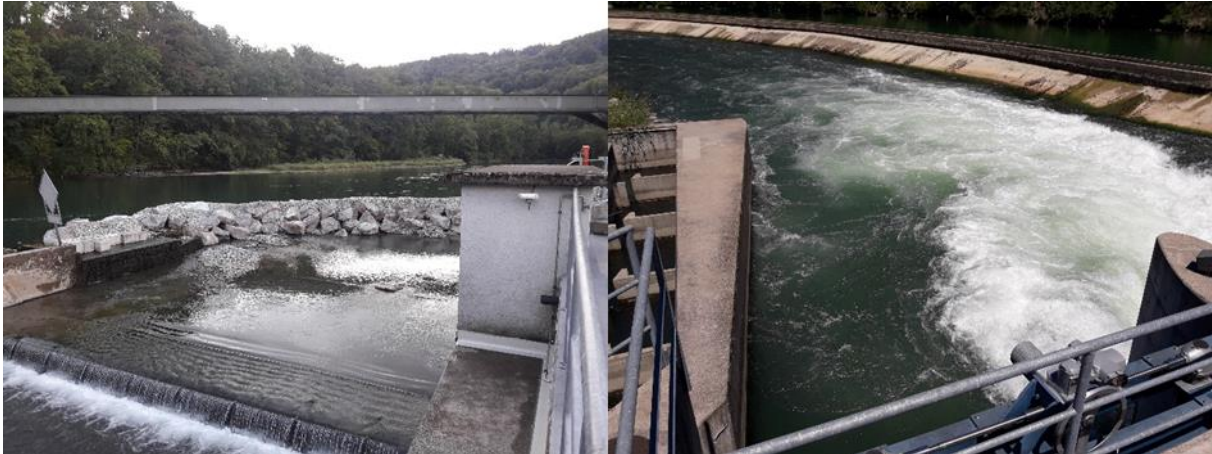
Abbildung 5: Links: Kofferdamm am KW Schiffmühle nach dem Defekt des Wehres. Rechts: Erhöhter Abfluss infolge Wehrröffnung am KW Schiffmühle.
