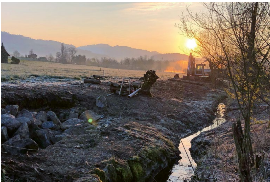
Die feinfühligste Gerinnemodellierung mit stabilem Unterboden schafft optimale Bedingungen für eine artenreiche Begrünung des Gewässerraums. Das Bild entstand während des Baus. (© S. Schmid)
