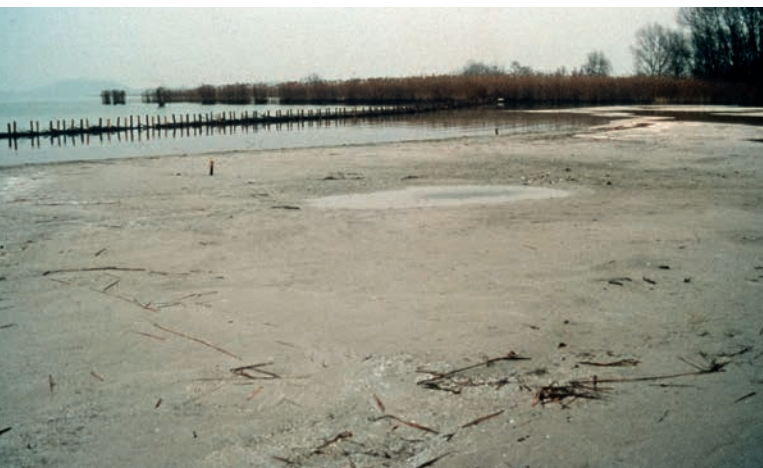
Abb. 28: Fertig ausgeführte Sandvorspülung bei tiefem Wasserstand. Das Material wurde im Schutz einer Lahnung in eine Bucht gepumpt [Erlach, Bielersee] | Fig. 28: Sable de reconstitution fini à faible niveau d'eau. Le matériel a été pompé dans une crique protégée par un barrage à claire-voie [Cerlier, lac de Bièvre]
