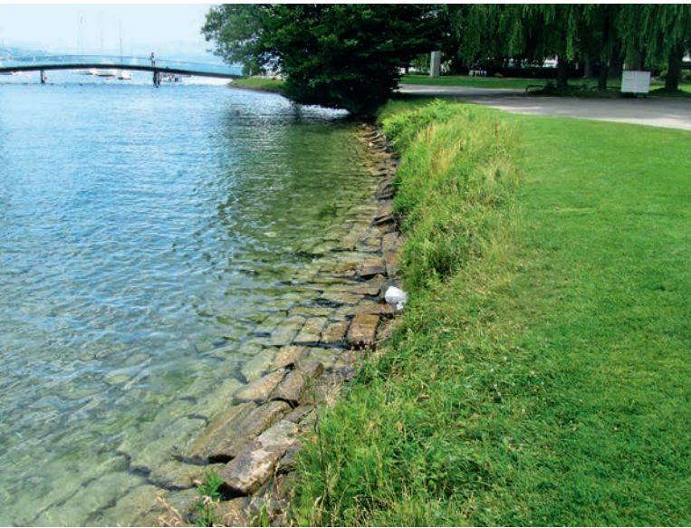
Abb. 6: Blocksatz am Ufer des Zürichsees bei der Landiwiese in Zürich Wallishofen. Wegen ungenügender Filterschichten zum feineren unterliegenden Material sind die Steinquader stellenweise abgesackt. Wellenströmungen haben die Steine unterspült | Fig. 6: Empierrement sur la rive du lac de Zurich près de la Landiwiese à Zurich Wallishofen. En raison de l'insuffisance des couches filtrantes sur le matériau sous-jacent plus fin, les blocs de pierre se sont enfoncés par endroits. Le déferlement des vagues a affouillé les pierres
