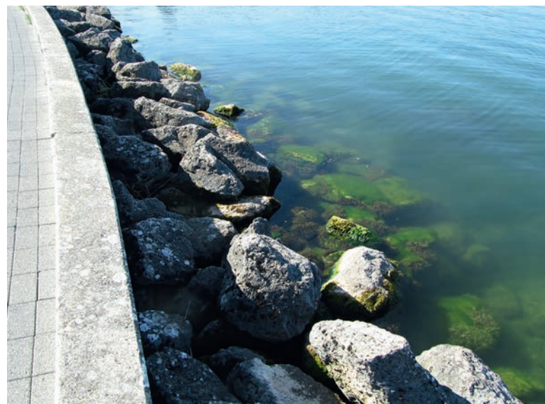
Abb. 4: Blockwurf zum Schutze einer Hafenjete bei Faaug am Murtnensee | Fig. 4: Enrochement afin de protéger une jetée près de Faaug sur le lac de Morat
