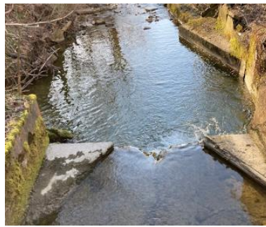
Abbildung 9: Stauwehr KW St. Georgen, St. Gallen
