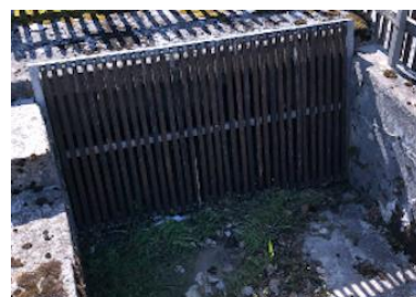
Abbildung 7: Leerer Einlauf KW Rufibach, Schänis
