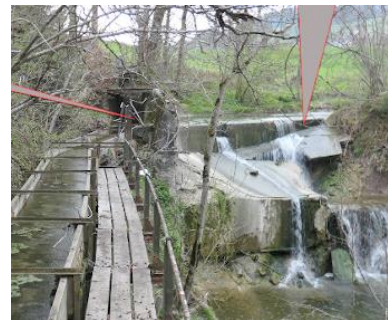
Abbildung 12: Fassung KW Tüfenbach, Neckertal
