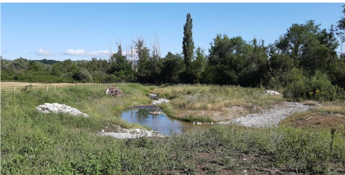
Abbildung 3: Neu gestaltetes Bachgerinne entlang der Landwirtschaftszone, © Stephane Giroud, sd ingénierie fribourg SA
