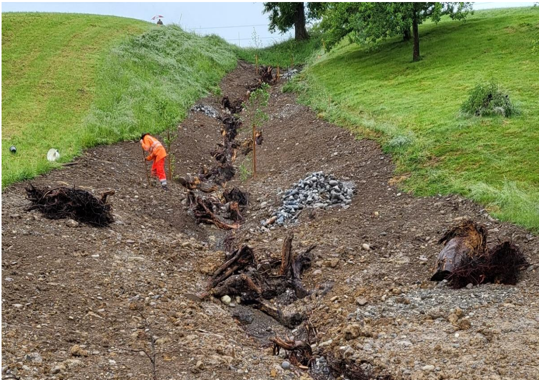
Abbildung 10: Steilstrecke mit Bachlauf und Wurzelstock-Schwellen nach Überschüttung (Juni 2022)
